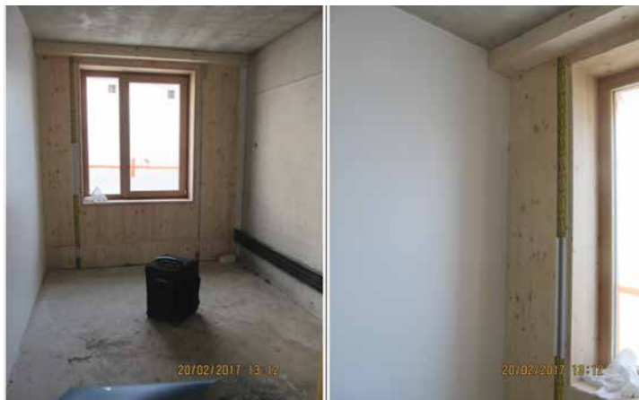
Mesurages acoustiques test réalisés sur chantier. L'objectif de DnTA \geq 40 dB entre bureaux est respecté entre les deux locaux témoins (source : ECHOLOGOS)
