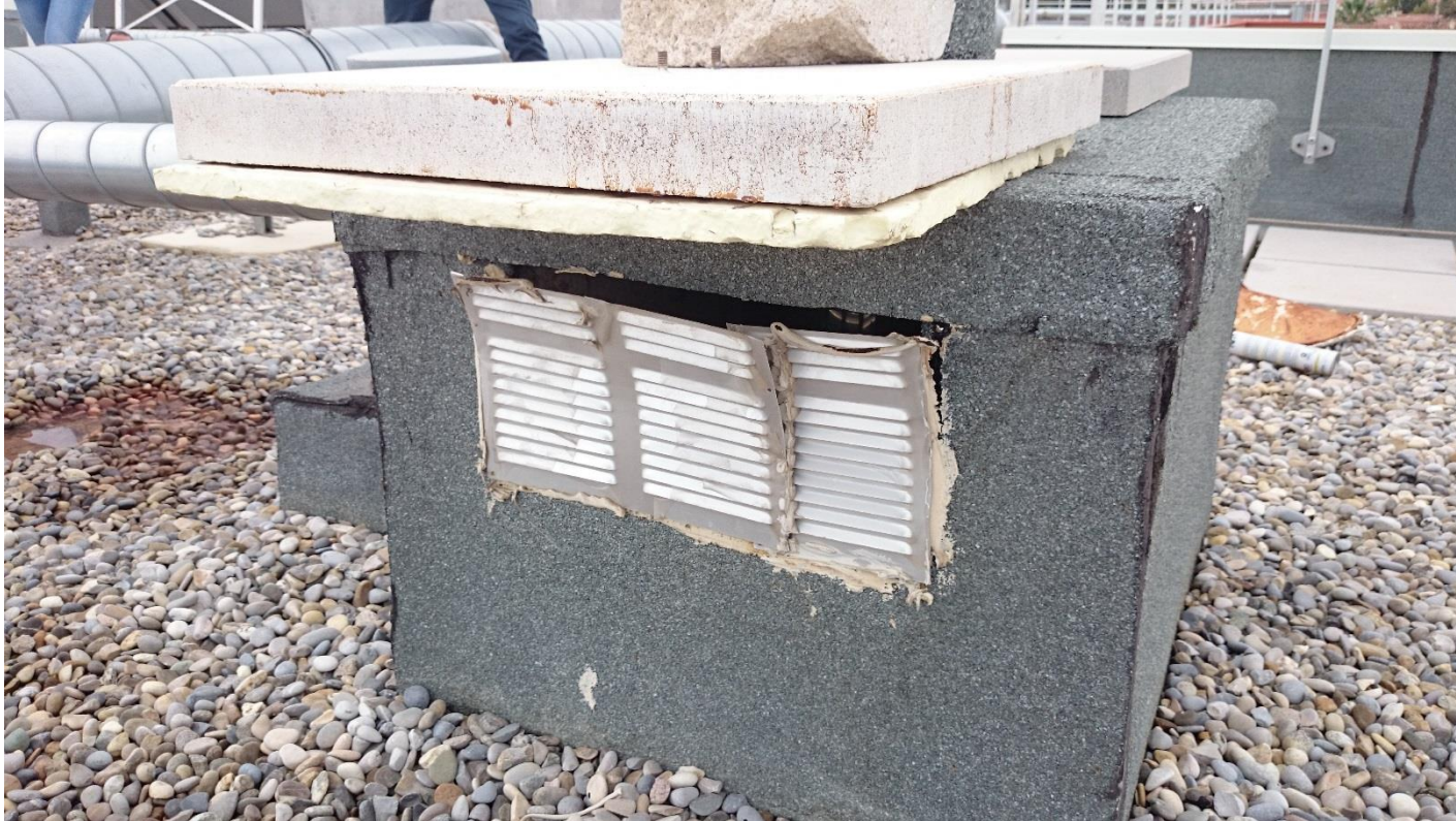
Fixation et/ou grille de ventilation inadaptée...
