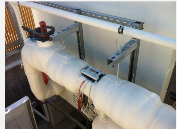
Compteur énergie chaud / froid PAC
