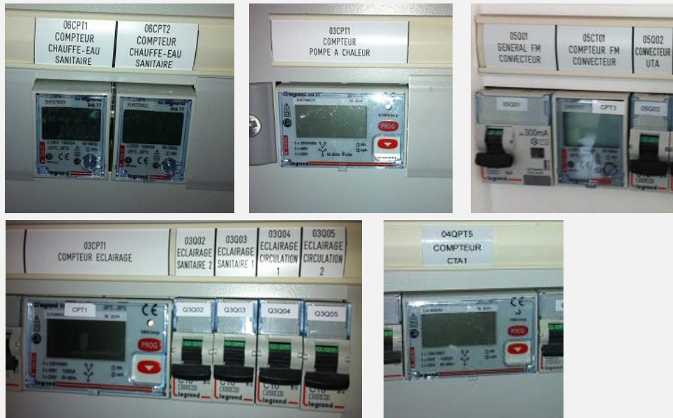
Sous compteurs électriques
