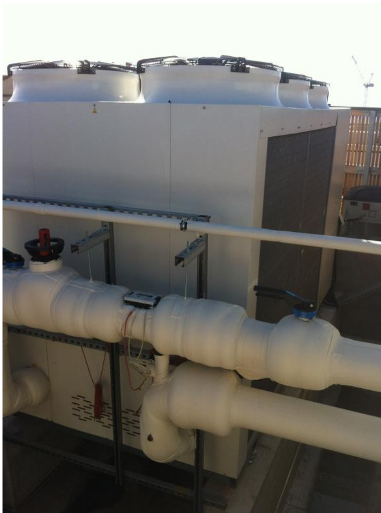
Pompe à chaleur
