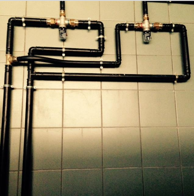
Calorifugeage réseau ECS
