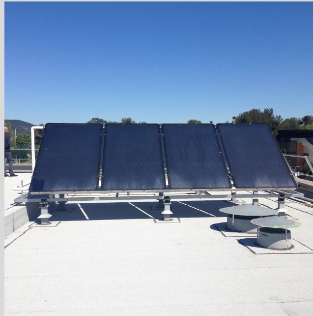
Capteurs thermiques ECS
