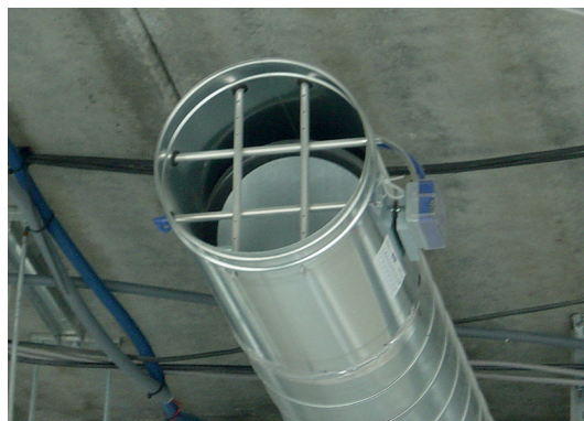
▲ Figure 45 : Mesure de vitesse par mesure de la pression dynamique en plusieurs points du conduit
