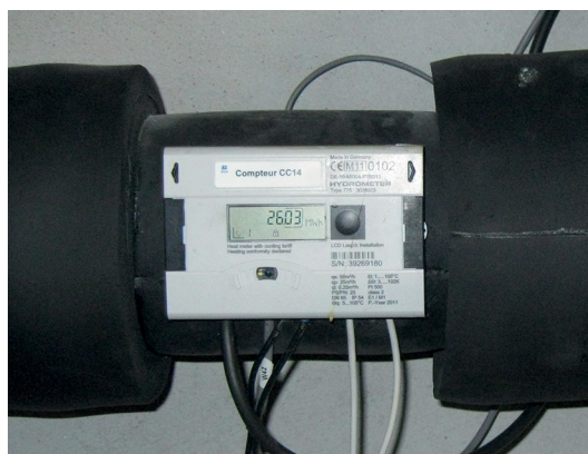
▲ Figure 36 : Compteur d'énergie thermique
