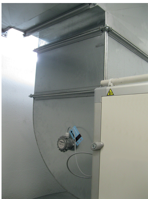
▲ Figure 42 : Sonde de mesure de température ponctuelle en place sur un conduit aéraulique
