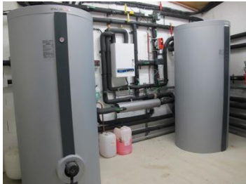
9 Ballons de stockage
