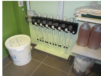
10 Vannes de réglage plancher chauffant
