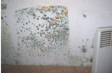
Contaminations fongiques sur un mur
