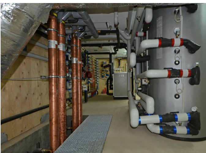
Système PowerPipe (récupération de chaleur sur eaux grises) et ballon d'eau chaude (ASP Architecte)
