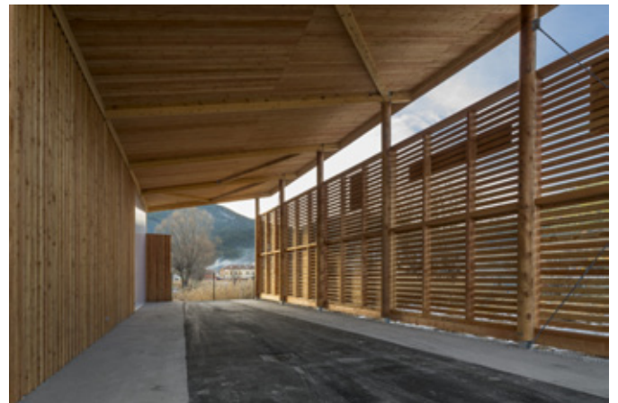
Aire de stockage
