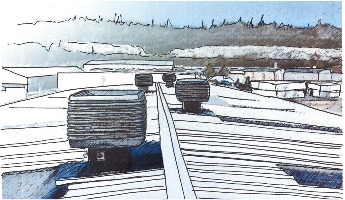
Rafraîchisseurs adiabatiques directs posés en toiture de hangar
