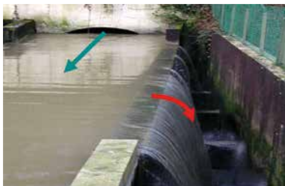
Figure 2 : DO latéral en fonctionnement (ville de Fontainebleau). Le débit déversé, indiqué par la flèche rouge, est variable le long du seuil de déversement avec un déversement plus important à l'aval du seuil – la flèche verte indique le sens de l'écoulement et symbolise le débit amont.
