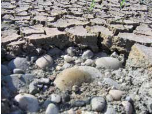
Photo 2 : Couche colmatée sur le bassin de Django-Reinhardt (source : ENTPE).
