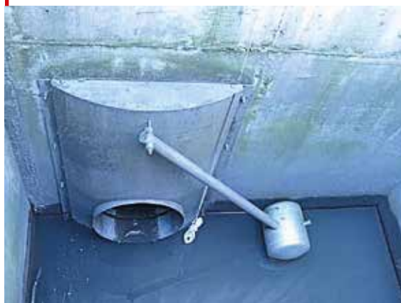
Figure 3 : Vanne-flotteur à la sortie du bassin de retenue-décantation Django-Reinhardt.
