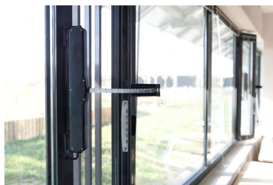
Figure 34 Ouvrants motorisés des salles de réunion – Bâtiment de bureaux Gamba à Toulouse
