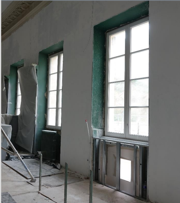
Menuiseries arrières changées non prévu
