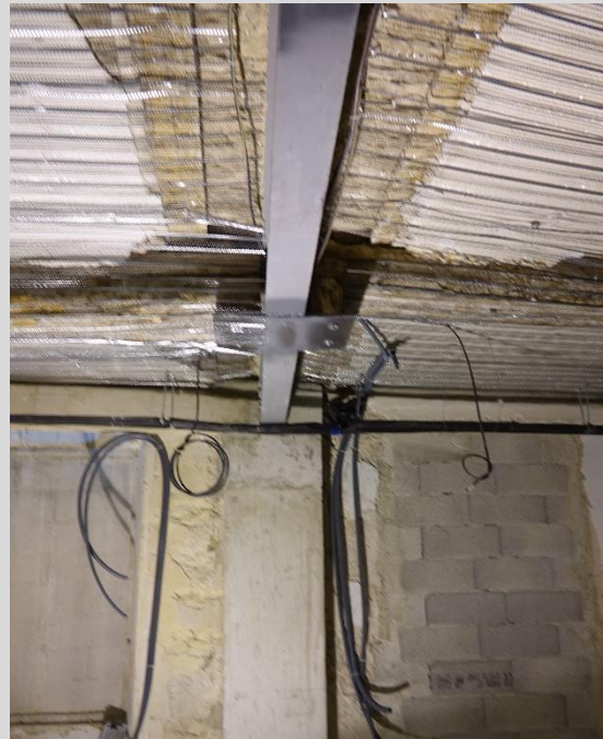
Reprise des planchers bois renfort avec des poutres en bois ou acier
