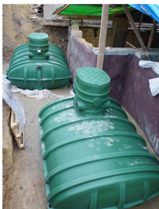
Cuve de récupération d'eau de pluie
