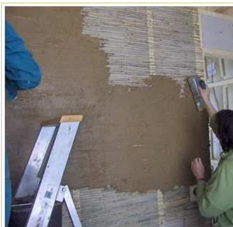
Plafonnage de cloisons à base d'argile, sable et paille de lin sur les roseaux
