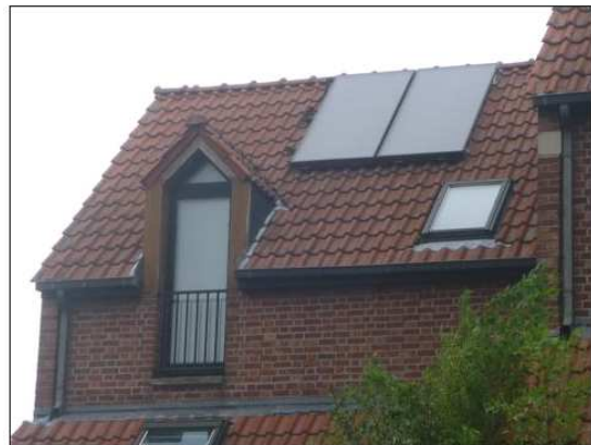
Capteurs solaires thermiques
