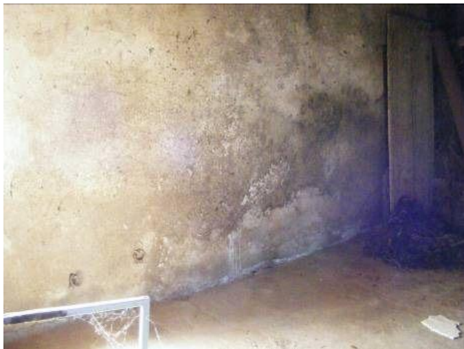
Remontées d'humidité – Source : Li Sun Environnement
