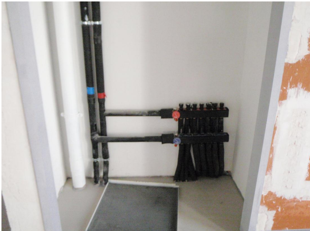
Calorifuge anti condensation
