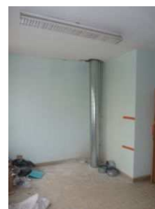
Gaine de ventilation dans la cage d'escalier
