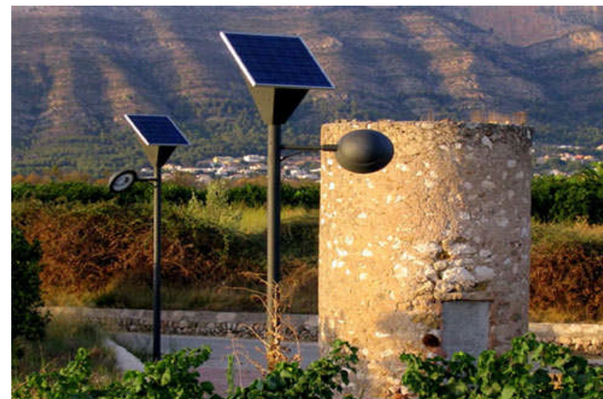
Exemple d'éclairage public solaire autonome / Source : http://www.habitat-eco-intelligent.fr/eclairage-solaire.html
