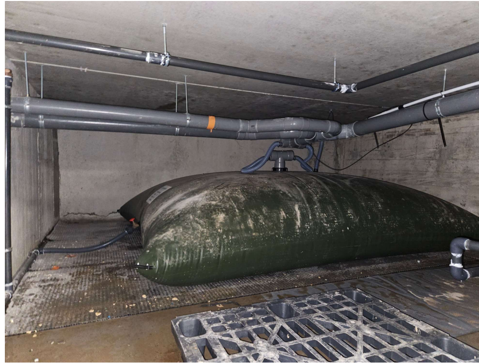
Bâche à eau 10 m 3 : alimente 1 WC dans le club house + puisage arrosage espace vert RDJ
