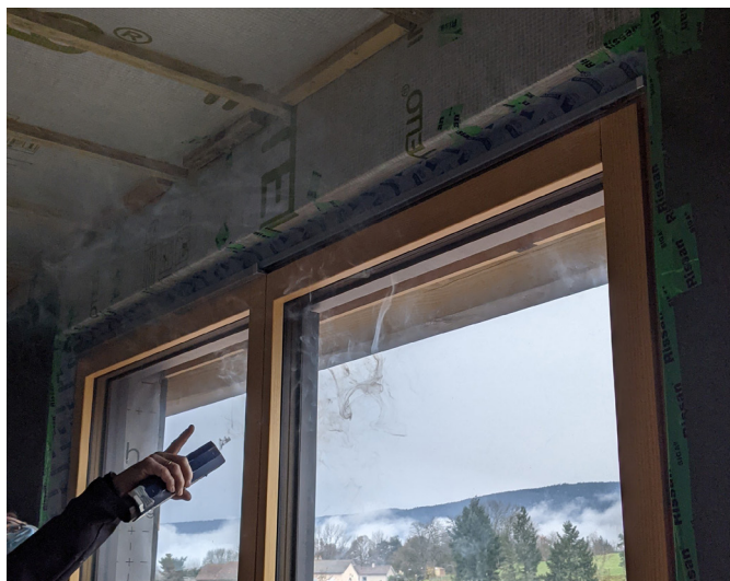
Vérification par test fumigène permettant d'identifier les défauts d'étanchéité de l'enveloppe ©Atelier d'architecture Rivat
