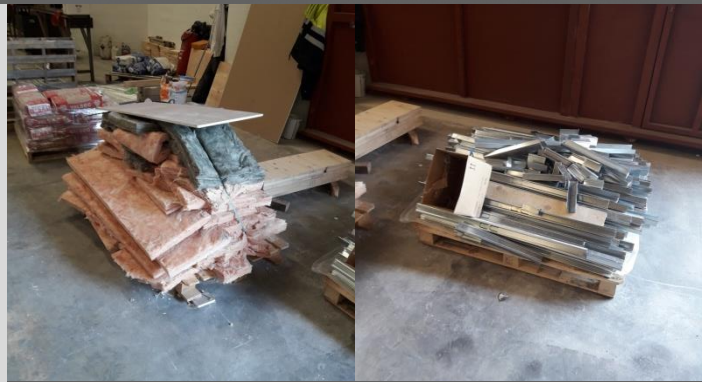
Stockage des déchets à l'intérieur
