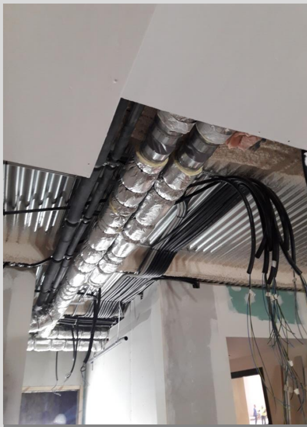
Réseaux VMC et électriques
