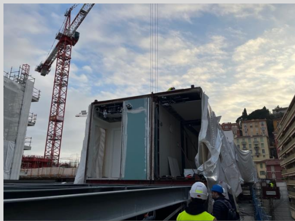
Pose des premiers modules du R+6 avec l'utilisation des grues de Grand Ida
