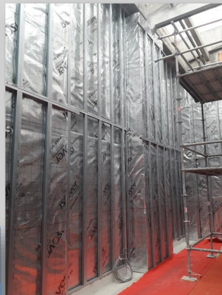
Membrane pare vapeur devant isolant liège
