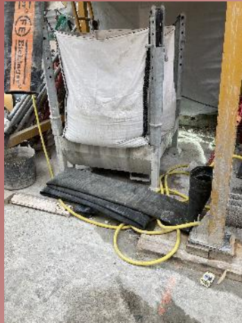
Big-bag décantation eaux de lavage
