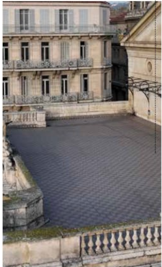
Toiture hall / foyer : terrasse en carrelage incompatible sur étanchéité, relevé périphérique non conforme favorisant des défaut d'étanchéité.
