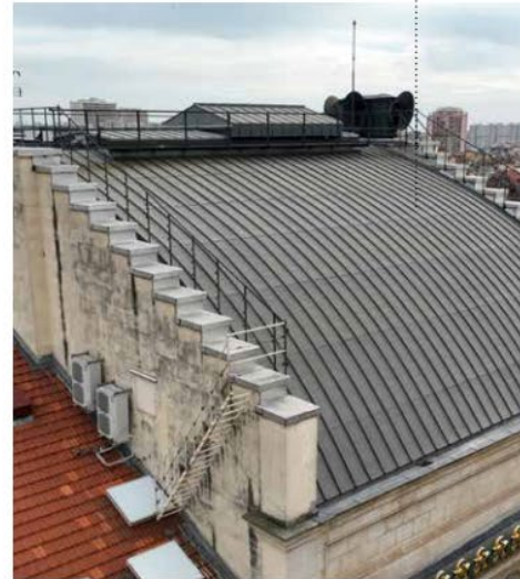
Toiture gril : zinc prépatiné sur tasseau, défaut d'étanchéité sur le mécanisme de désenfumage, habillage des arases maçonnée de type Mammouth inadapté.
