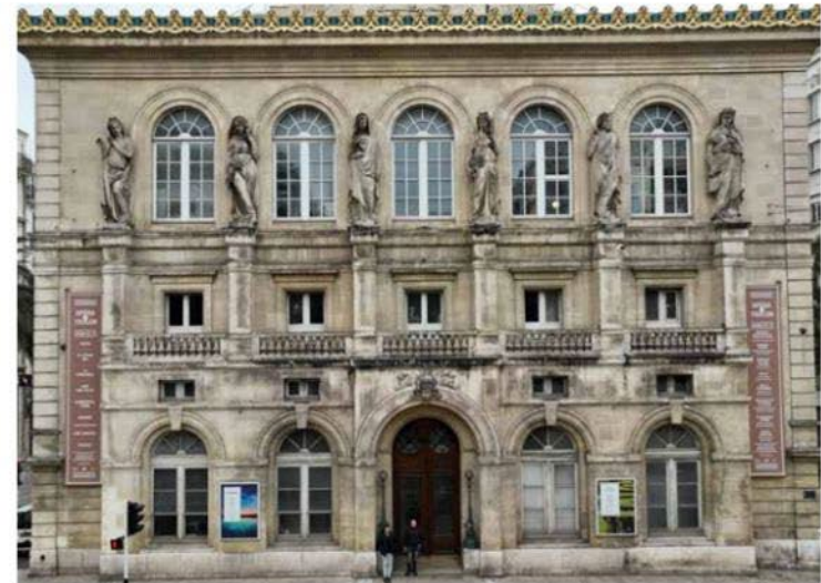
Façade Nord: Encrassement généralisé, végétation parasitaire, coulures causées par l'absence de protection sur les bandeaux et corniches, croustes noires localisées sous les balcons. La statuaria devra faire l'objet d'un nettoyage et d'une protection spécifique.
