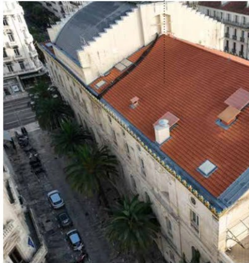
Toiture scène : couverture refaite entièrement à neuf en 2014 avec isolant Sarking, tuile mécanique marseillaise, chéneau en zinc et édicules divers de ventilation, câbles d'alimentation apparents.
