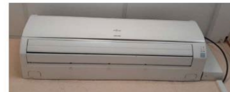
VRV + Unités extérieures réutilisés sur site
