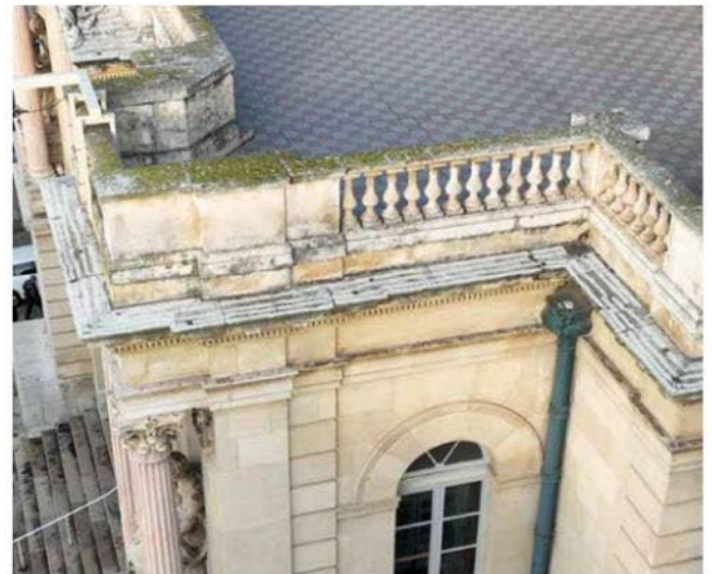
Façade Sud: Absence de protection sur les bandeaux et corniches, défaillance du système anti-pigeon entraînant des dégradations sur les statues, végétation parasitaire sur la balustrade, vérification du réseau de descente EP en fonte.
