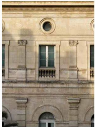
Façade Est et Ouest: Coulures causées par l'absence de protection sur les bandeaux et corniches.
