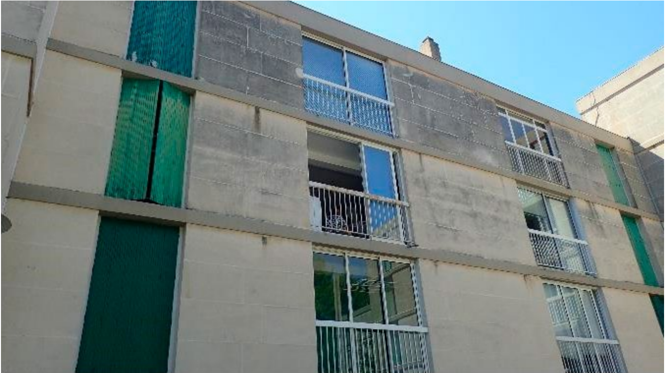
Dégradation par création de loggia
