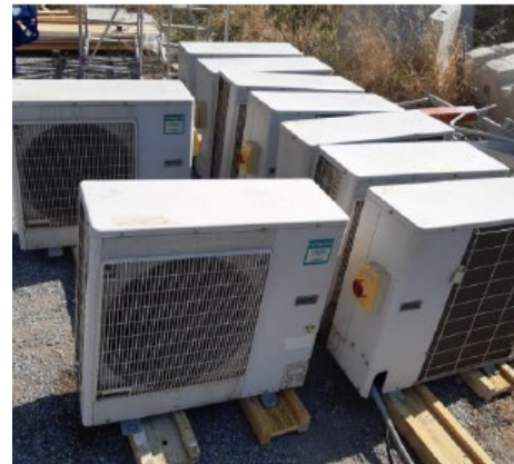
Groupes de climatisation
