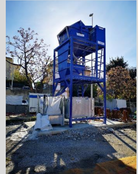
Bac décantation laitance béton
