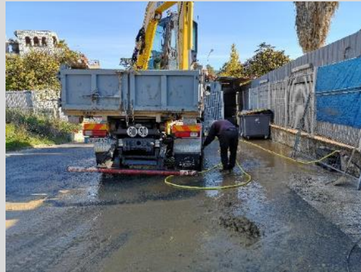
Aire de lavage des engins
