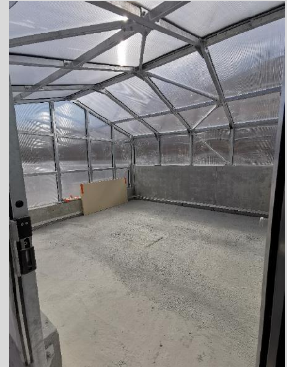
Espace de stockage du matériel d'entretien en toiture
