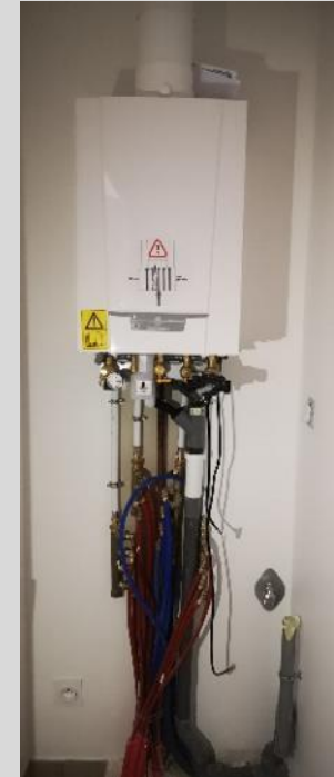
Chaudière individuelle gaz à condensation
