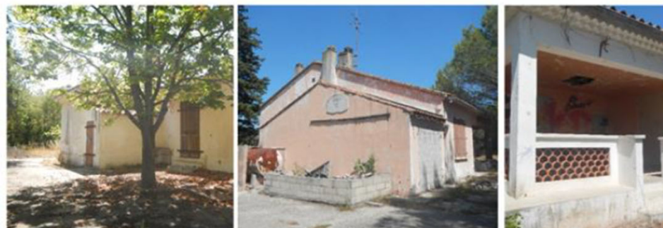
7 - MAISONS // ETAT DÉGRADÉ
