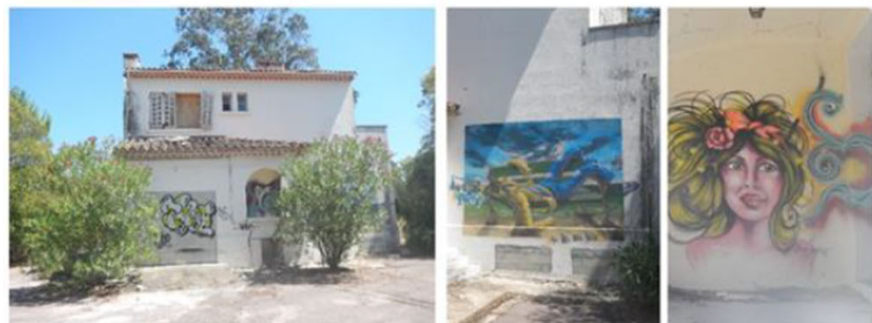
2 - MAISON DE DIRECTION // ETAT DÉGRADÉ
