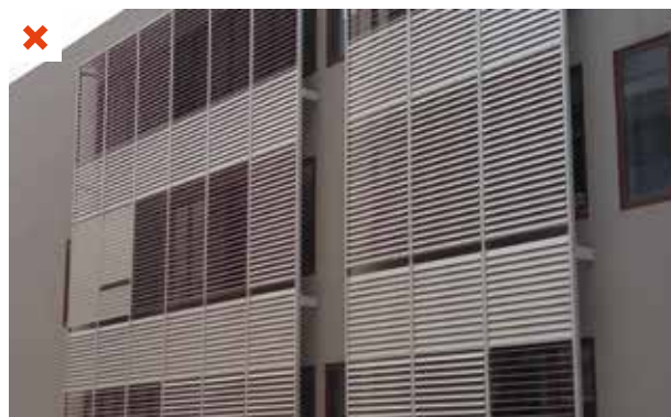
Tous les brise-soleil ne sont pas utilisés par les occupants pendant une journée ensoleillée d'été. ©AQC
