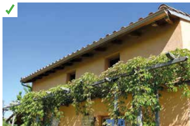
Bon développement de la protection végétale grimpante sur la pergola. ©AQC
