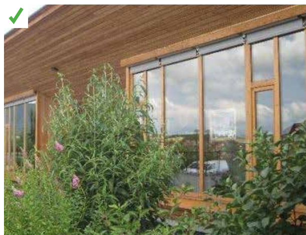
Stores extérieurs en textiles contribuant, en complément de la casquette correctement dimensionnée, à éviter les surchauffes et l'éblouissement en été sur la façade sud. ©AQC
