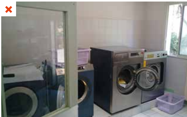
Inconfort thermique constaté dans une pièce mitoyenne à une buanderie dû à la chaleur dégagée par les machines à laver. ©AQC
