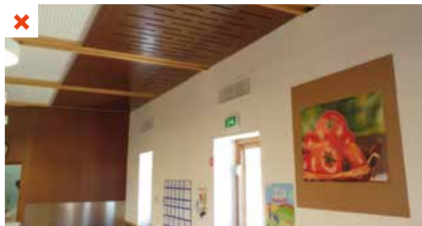
Dans cette cantine, les entrées d'air en imposte pour la ventilation naturelle sont sous dimensionnées pour le rafraîchissement nocturne. ©AQC
