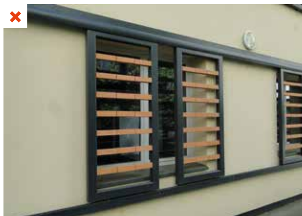
Brise-soleil coulissants sous-dimensionnés. ©AQC
