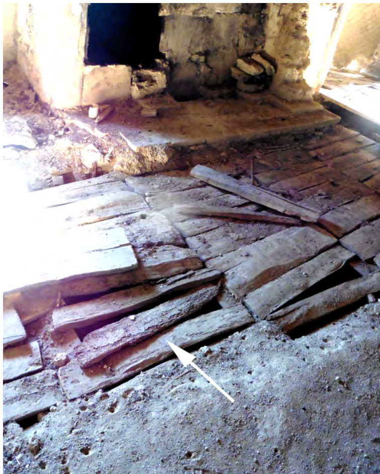
Illustration 3: Plancher de palets, support d'une chape de torchis, vu par dessus (Gers). (Sophie Popot)
