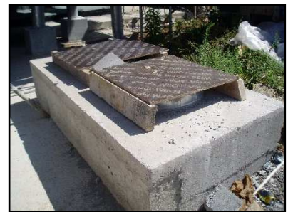
Prise d'air du puits canadien, à l'arrière du bâtiment (côté sud)
