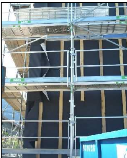
Ossature bois visible sur la façade nord, avant la pose de la laine de roche
