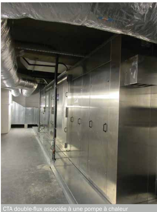
CTA double-flux associée à une pompe à chaleur
