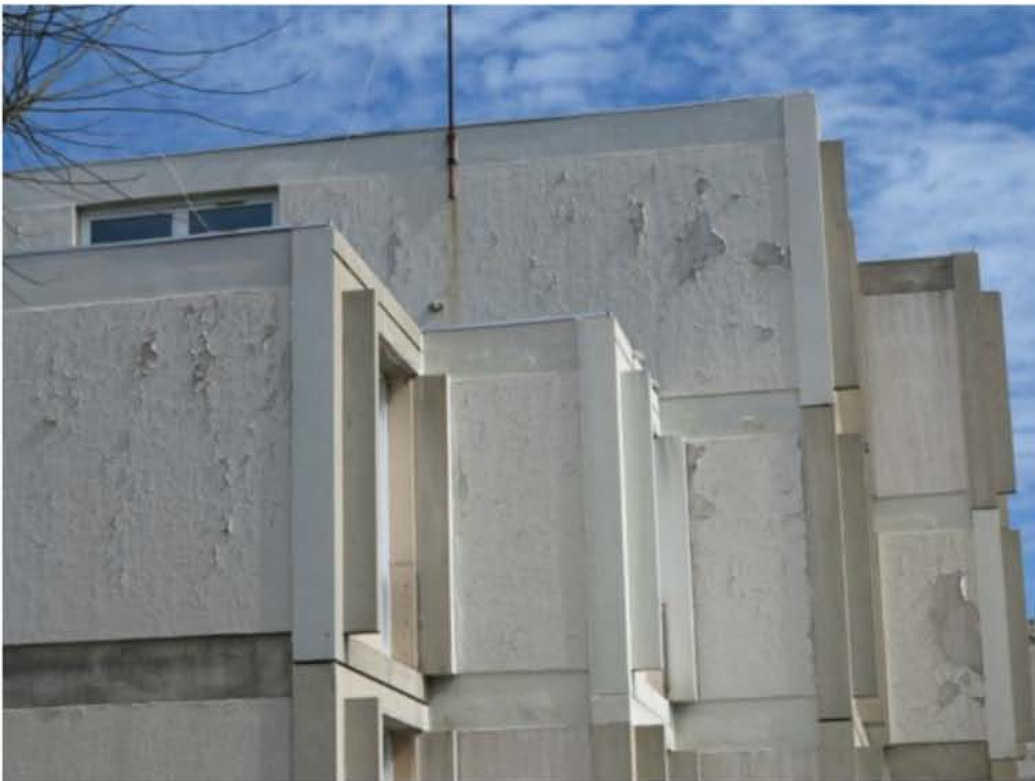
Dégradation de la peinture
