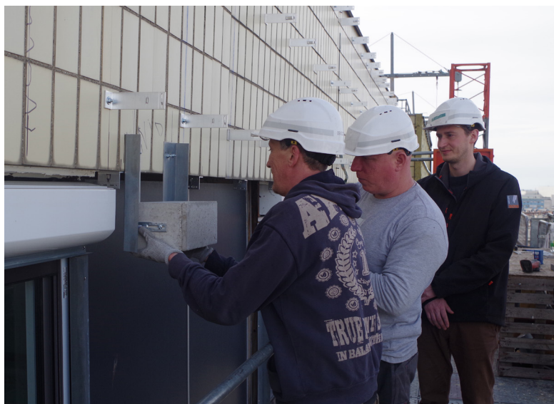
Pose d'un nichoir à martinets par des façadiers sur le site pilote AP-HP © LPO
