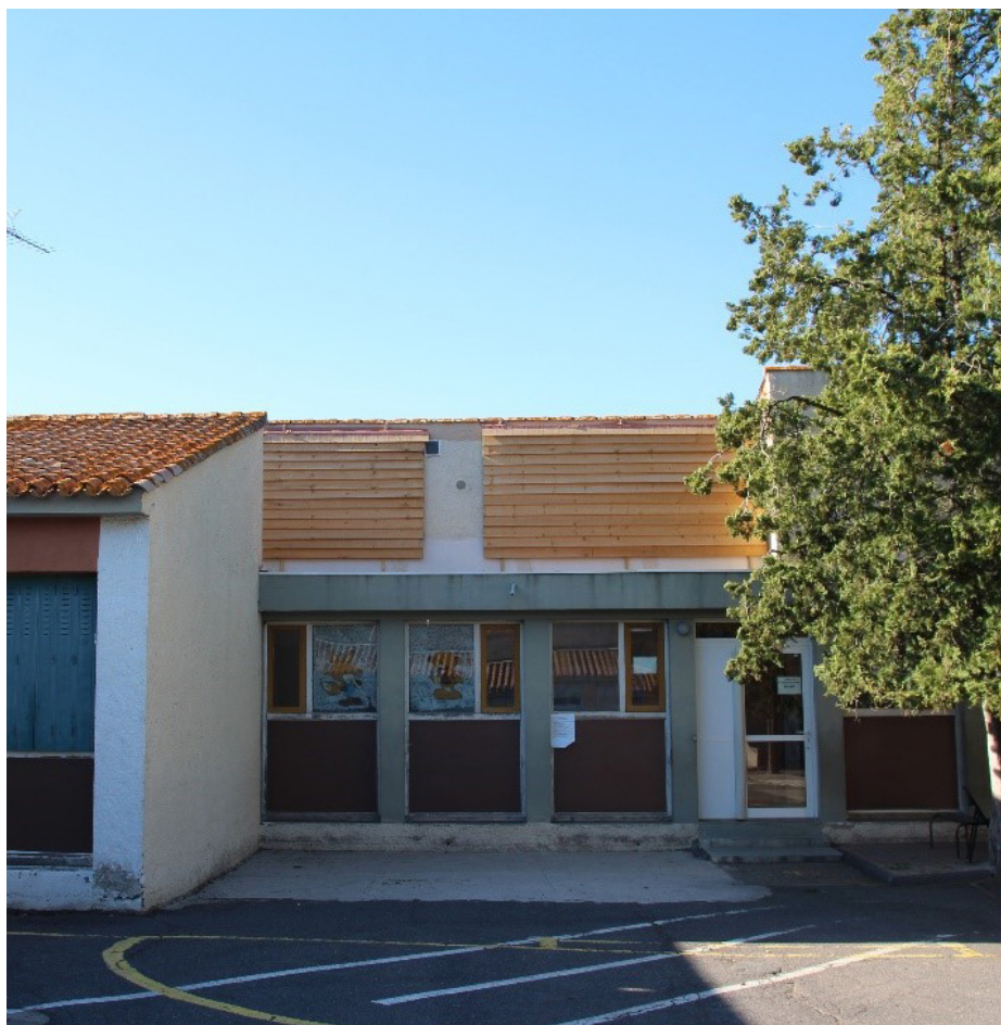
Pose d'un bardage sur une école pour créer des gîtes de repos/transit pour une colonie de Pipistrelles pygmées © Camille Montegu - LPO
