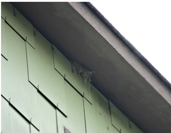
Nid de moineaux dans l'espace entre l'isolant et le toit © Maëva Felten
