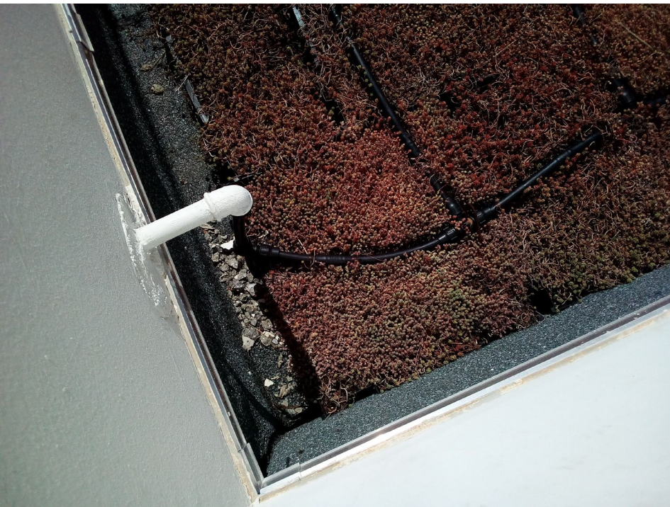
Point d'eau en toiture
