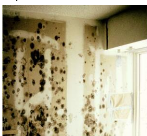
Moisissures par condensation superficielle
