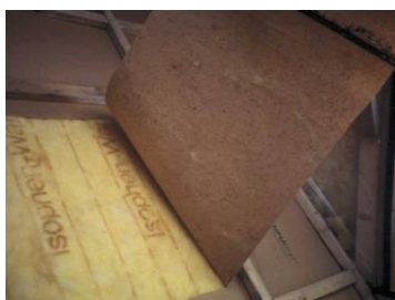
Moisissures sur la face intérieure du pare-vapeur (condensation estivale)
