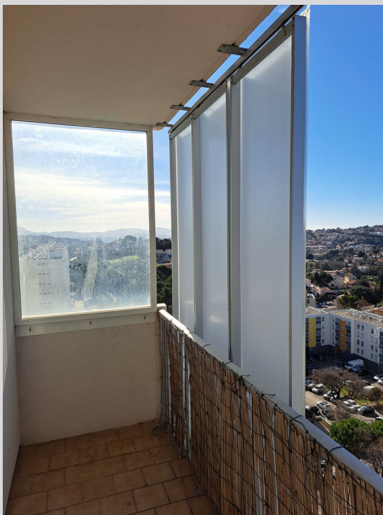
Panneaux coulissants fonctionnels et utilisés
