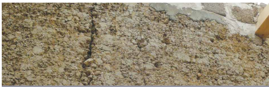
Fissure verticale détectée au niveau des arases des murs
